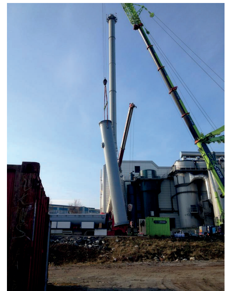
Nytt renseanlegg ble satt i drift i juli. Nesten samtlige målinger viser nå at Tafjord Kraftvarme er nær ved å nå sitt miljømål; utslipp som er under 50% av de krav myndighetene har satt.
