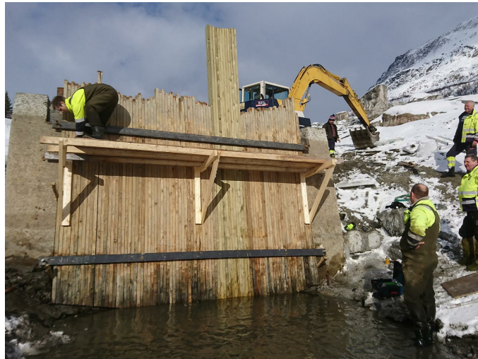
Nålestengsel ble montert ved inntaket til Fremste Kaldhussætervatn før revisjon av tappetunnelen kunne settes i gang.
